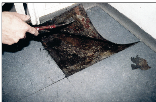
Skimmelsvamp under gulvbelægning (Kilde www.skimmel.dk )
